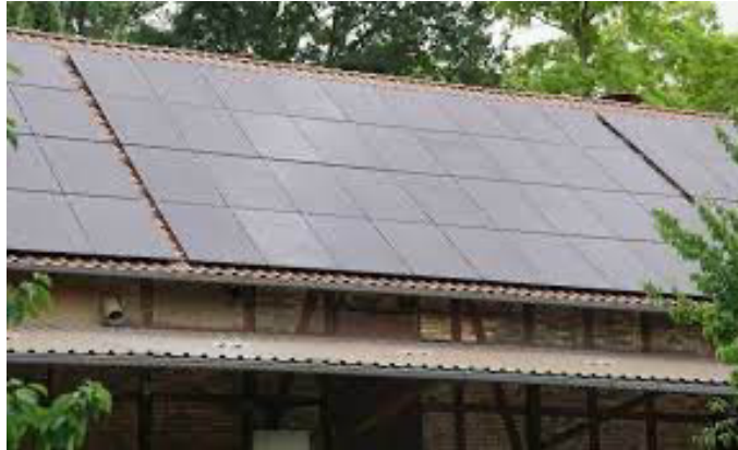
Lindenhof Eilum 2023, EAW-Anlage, 29,6 kWp, EEG-Einspeiseanlage
